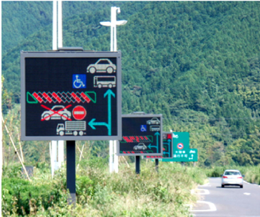
図 1-3 駐車場誘導システムの表示内容の検討（清水 PA 上り線）
