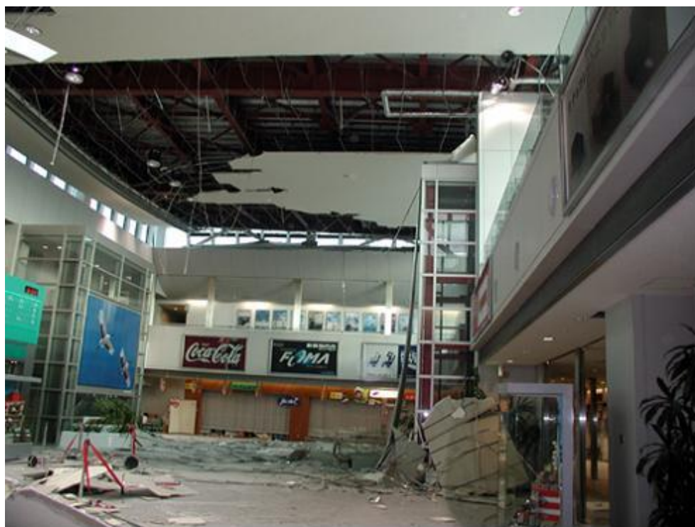
図 1.1 十勝沖地震被害例（2003年 空港ターミナルビル）
