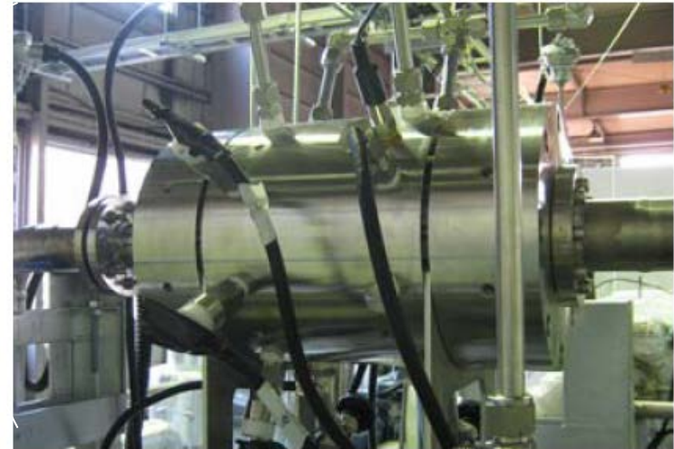
図 2.3-16 ガスタービン発電機の外観
