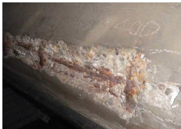
写真 5.1.2 かぶりコンクリートの剥離状況
