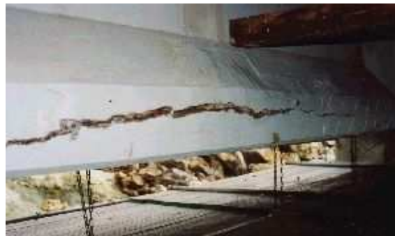
写真 1.1.5 フランジ側面の腐食ひび割れ
