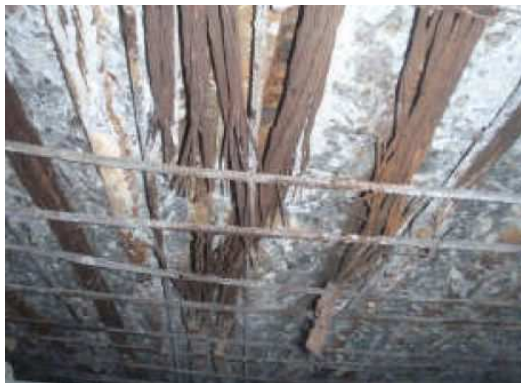
写真 1.1.10 妙高大橋の鋼材破断 4)
