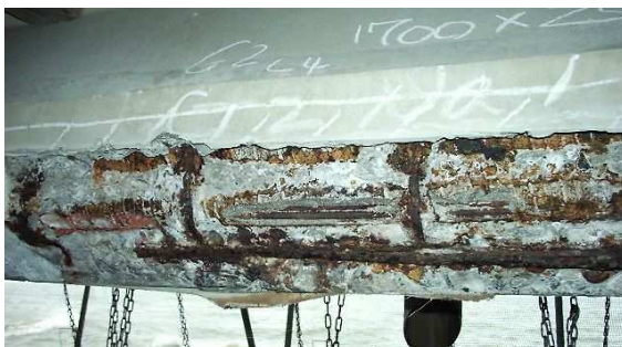
写真 1.1.6 内部の鋼材腐食
