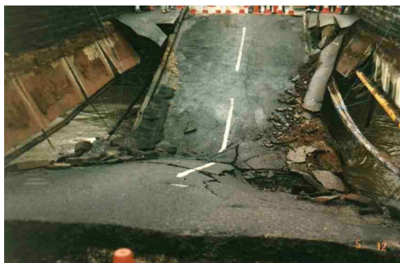
写真 1.1.11 英国 Ynys-y-Gwas 橋の落橋事故
