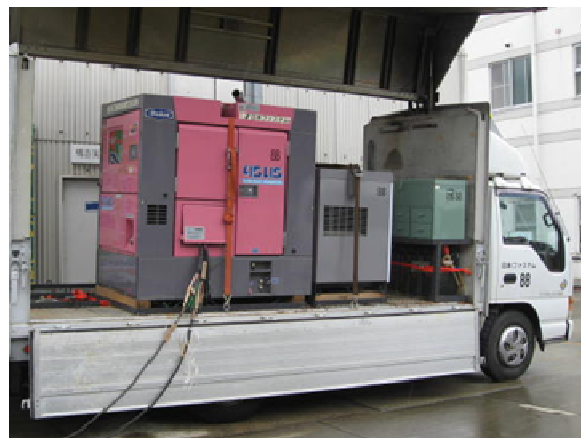
写真 2.3.4 電源ユニット
