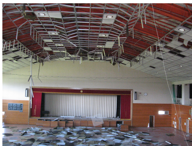
写真2.6 システム天井落下
