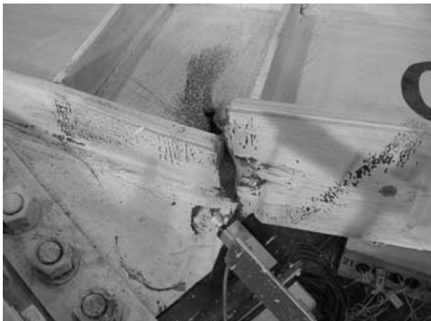
(a) ガセットプレート近傍の鉄骨梁下フランジの破断
