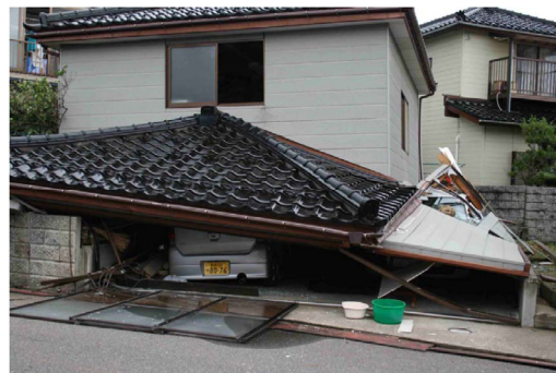
写真 1.8 1階にガレージを持つ木造住宅の被害 6) (2007年新潟県中越沖地震)
