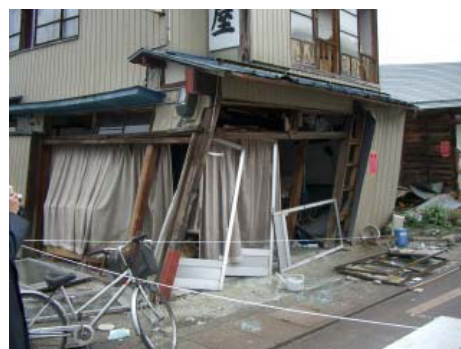
写真1.4 1階が2面開口となった木造住宅の被害 3) (2004年新潟県中越地震)
