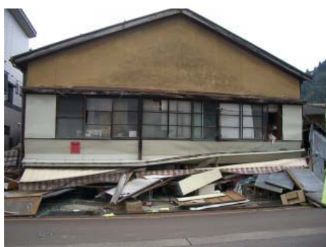
写真1.3 店舗併用住宅の被害 3) (2004年新潟県中越地震)
