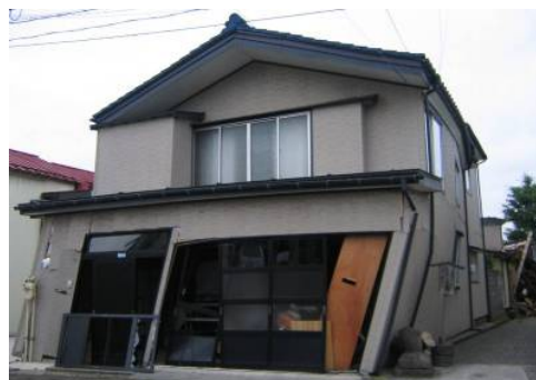
写真 1.7 接道面に大きく開口を取った木造住宅の被害 5) (2007年能登半島地震)
