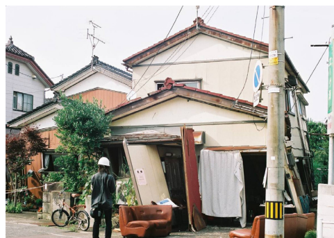
写真 1.6 接道面に大きく開口を取った木造住宅の被害 5) (2007年能登半島地震)
