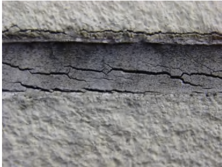
写真 1-4 耐候劣化による表面のひび割れ
