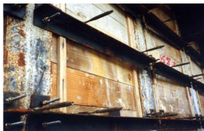
横アンゲルと山留の隙間に下地材を潜り込ませるような施工となり、施工効率的にも、品質的にも
