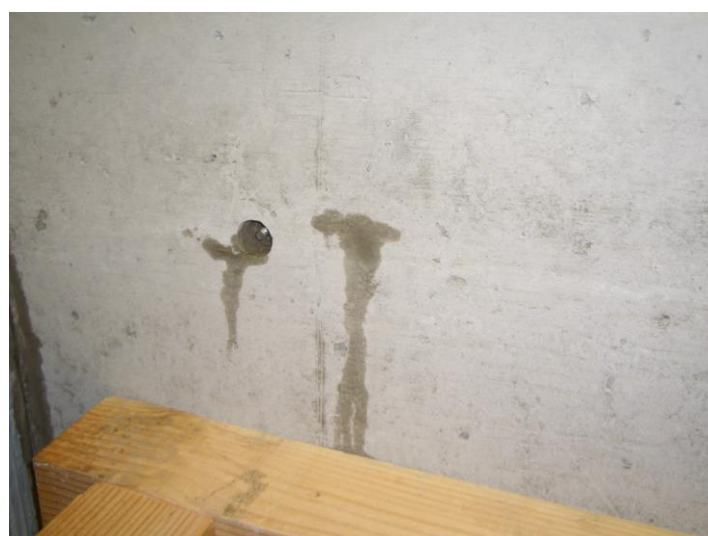
写真 4.12 コンクリート面 染み出し (塗膜系)
