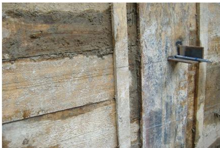
写真 3.7 矢板ずれ止め位置不適切
