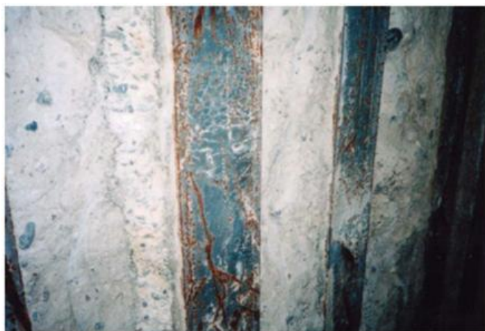
写真 3.2 ソイルセメント面の凹凸
