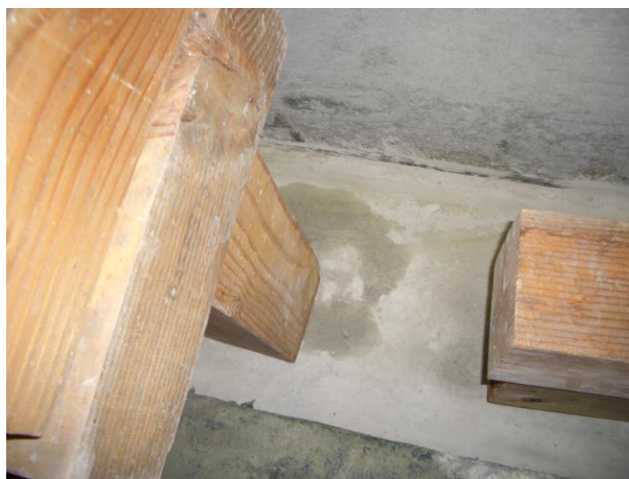
写真 4.13 パイプ周り染出し (シート系)
