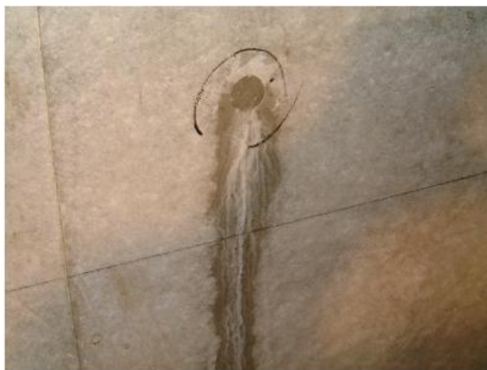
写真 3.27 セパレーター部からの漏水
