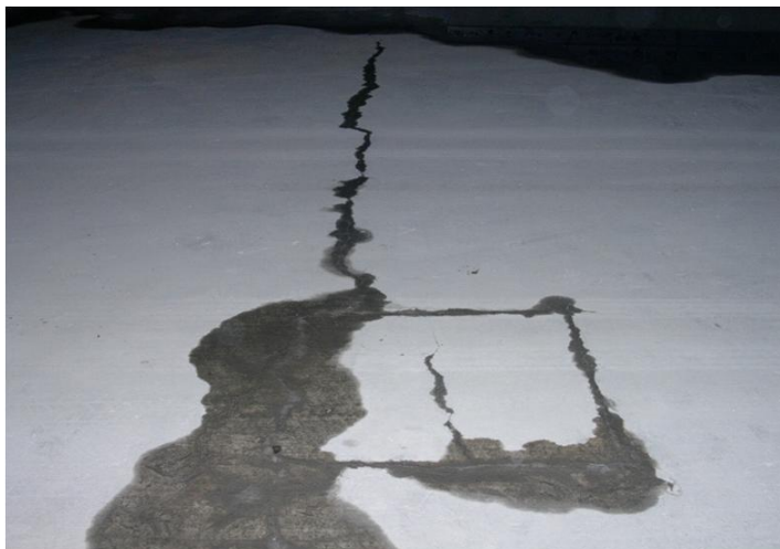
写真 3.25 底部切梁支柱周辺からの漏水
