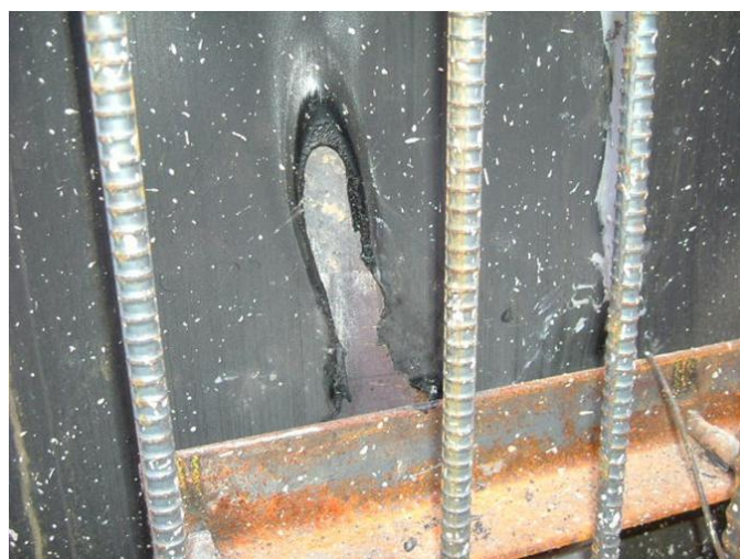
写真 3.24 溶接火花による防水層融解
