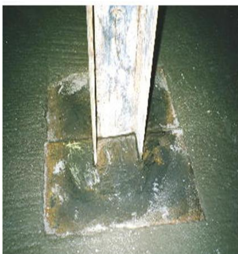
写真 3.11 切梁支柱の錆び・汚れ
