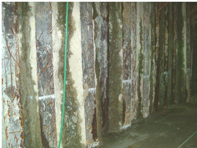
写真 3.1 芯材H鋼の施工精度不良
