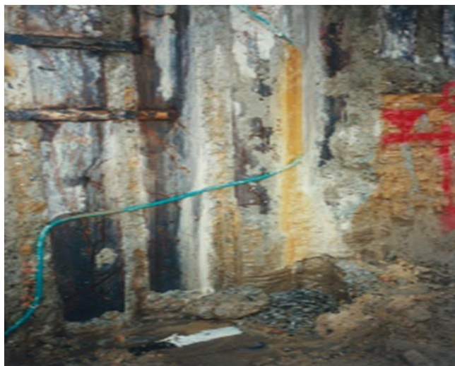
写真 3.4 SMWからの漏水
