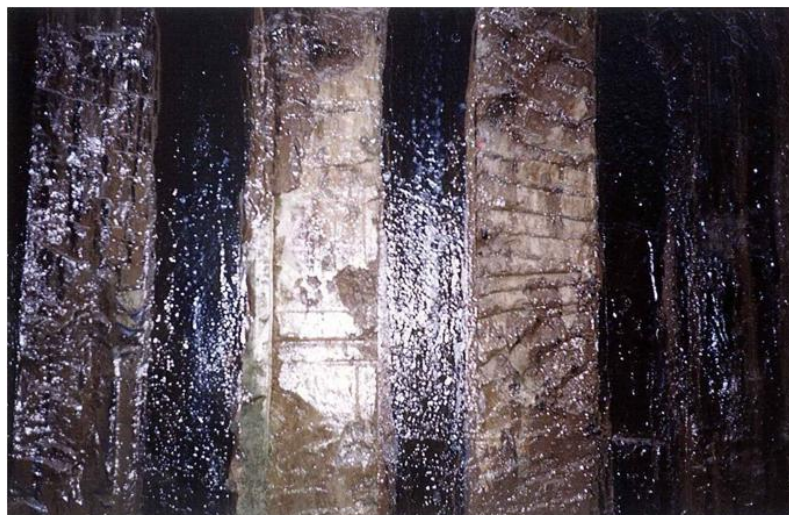
写真 3.19 湧水による防水材流出
