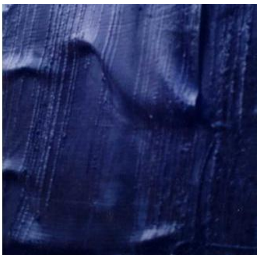
写真3.15 自重による防水層だれ，口開き
