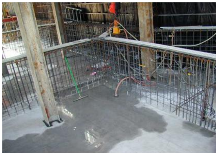
写真 3.12 導水層不良での漏水
