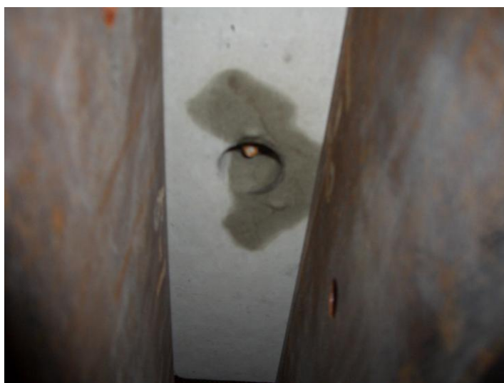
写真 5.4 漏水状況 (試験体④)
