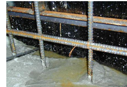
防水層の脆弱な部分から、背面被圧水が湧き出てきている様子
