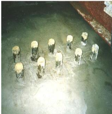
付着物で汚れたフランジ付きパイプ
