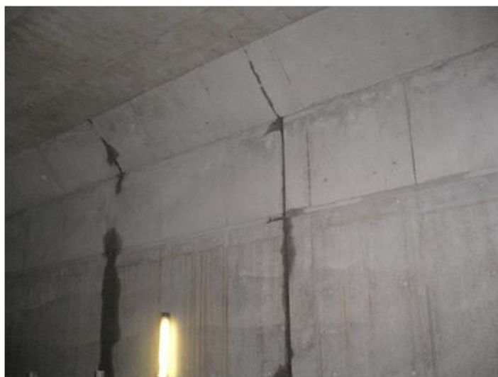
写真 3.26 ひび割れ誘発目地からの漏水
