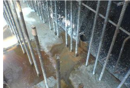
鉄筋により穴が開けられ、防水層
