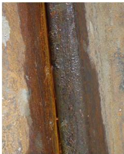
写真 3.8 シートパイルのジョイント段差
