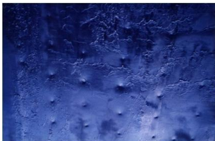
写真3.16 塗膜系防水材料の塗厚むら
