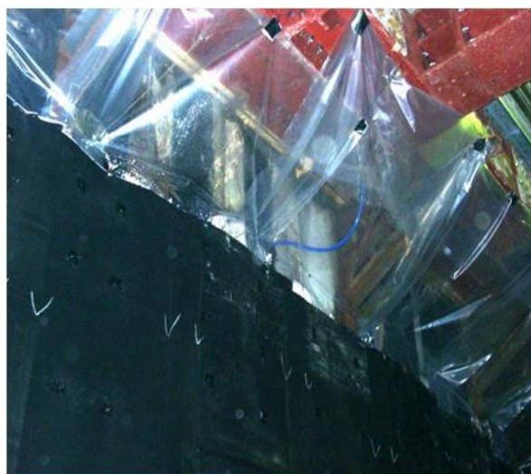
写真 3.20 降雨による接合不良と養生例
