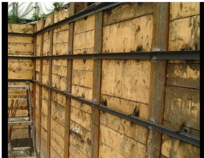
写真 3.10 防水施工不可能なアングル位置 アングル設置不良例
