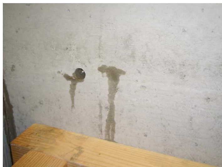
写真 4.12 コンクリート面 染み出し (塗膜系)
