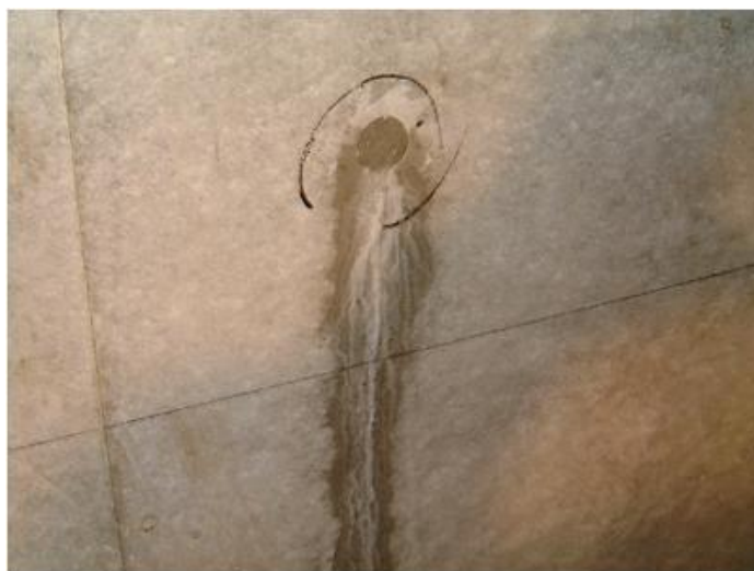
写真 3.27 セパレーター部からの漏水
