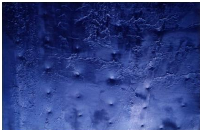
写真3.16 塗膜系防水材料の塗厚むら
