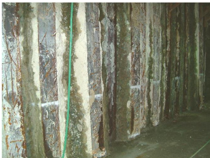
写真 3.1 芯材H鋼の施工精度不良
