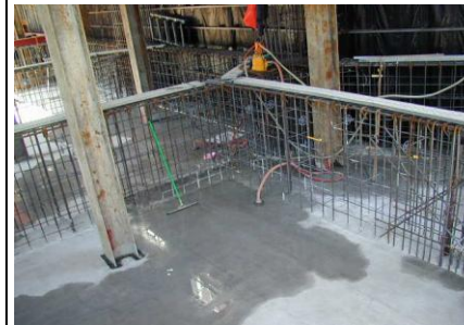
防水層から湧き出てきた水が打設したコンクリートに広がっている様子
