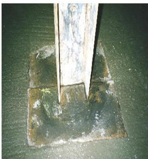
写真 3.11 切梁支柱の錆び・汚れ
