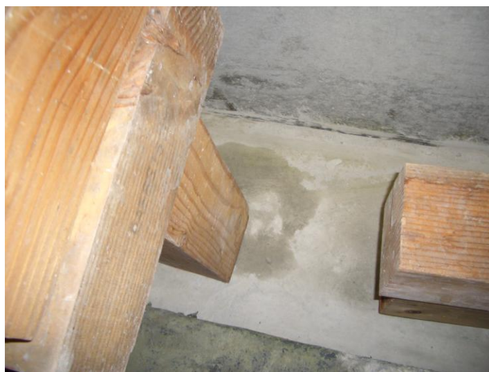
写真 4.13 パイプ周り染出し (シート系)
