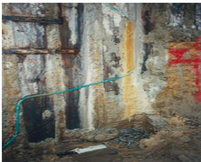
写真 3.4 SMWからの漏水
