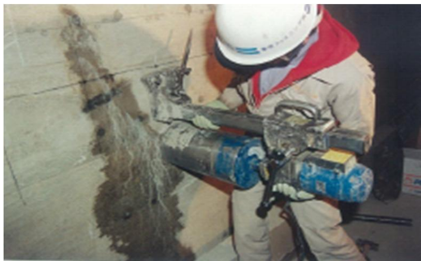
写真 3.28 セパレーター，打継ぎ部漏水調査
