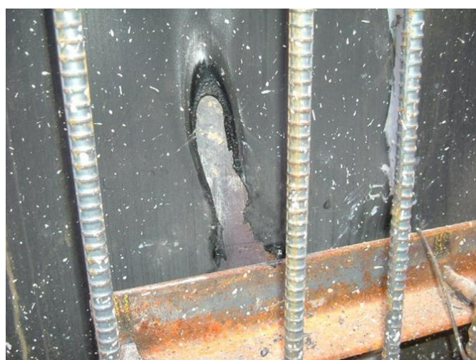
写真 3.24 溶接火花による防水層融解
