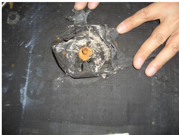
写真 5.7 防水層下の空隙（試験体③ 鉛直打設／一般／最下段）
