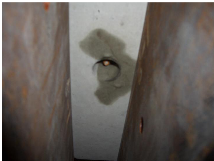
写真 5.4 漏水状況 (試験体④)
