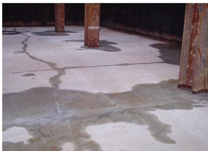
写真 3.18 底部貫通部止水処理不良
