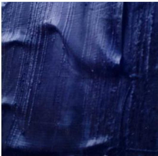
写真3.15 自重による防水層だれ，口開き
