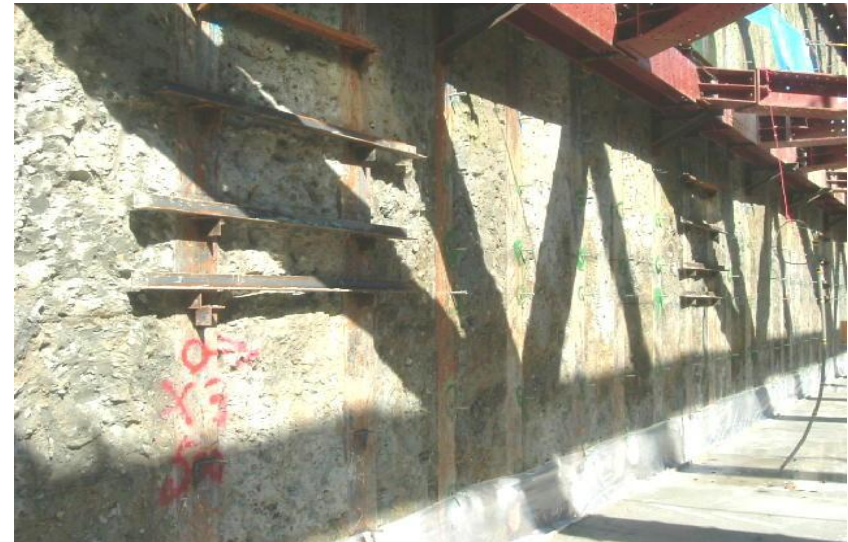
小さいが鋭角な不陸があるSMW壁で下地緩衝材を除外
