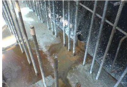
鉄筋により穴が開けられ、防水層
