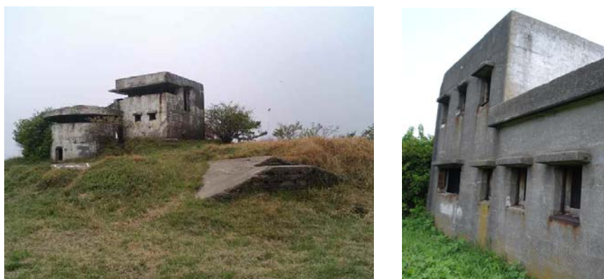
構造物 (b) (東側からの外観とコアを採取した西向き壁面)
