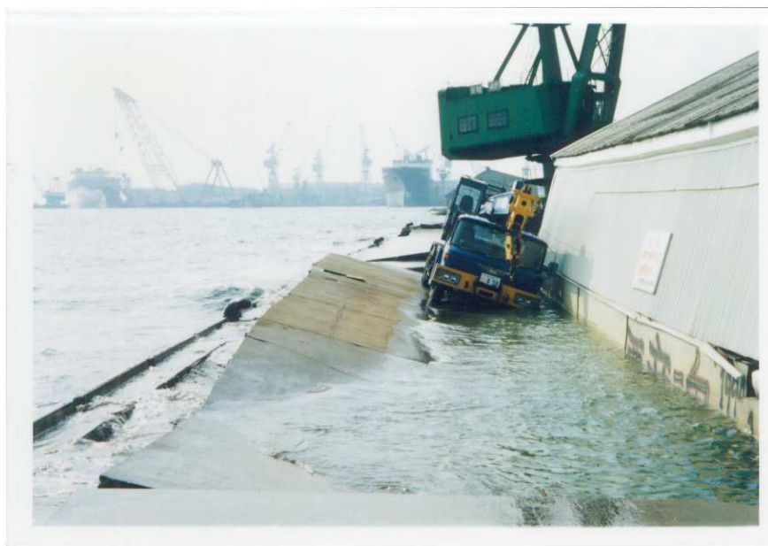
写真－1.1 阪神・淡路大震災による神戸港の被害の一例
