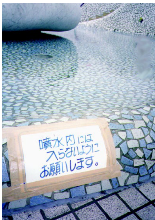
張り紙のようす 段差が低いために容易に人が侵入できる
