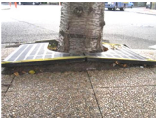
写真2.3 根元保護材の持ち上がり
