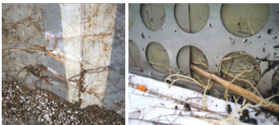
写真4.1 防水層ジョイント部に侵入した根系
