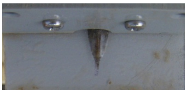
写真5.9 シート防水ジョイント部の剥離状況(溶着剤による接着)
