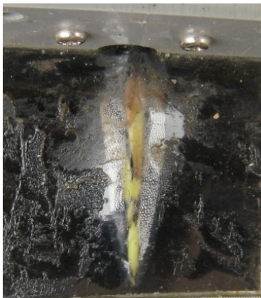
写真5.9 シート防水ジョイント部の剥離状況(両面接着シートによる接着)2/2
