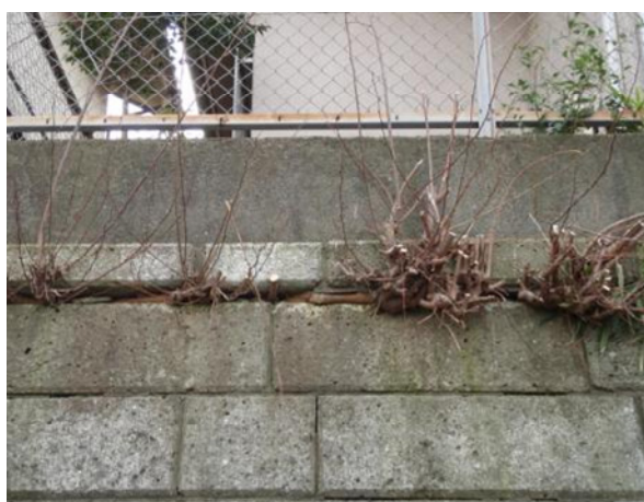
写真1.2 根による石組壁の損傷事例
