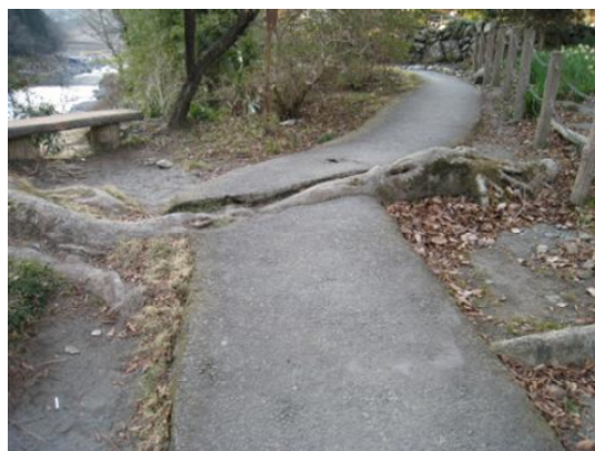
写真2.2 アスファルト舗装の分断
