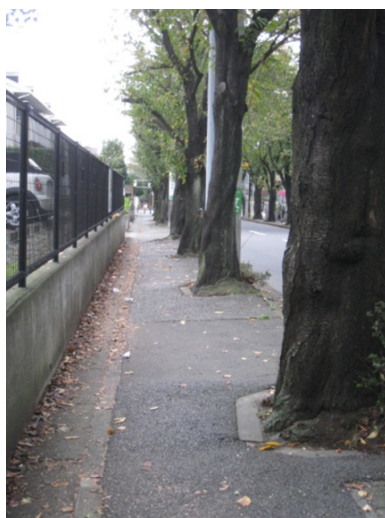
写真3.7 アスファルト舗装の不具合調査地
