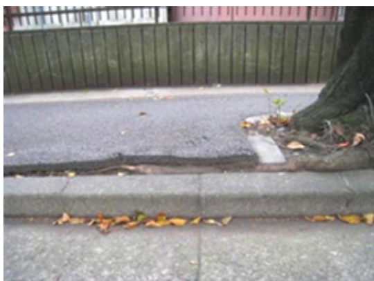
写真2.1 縁石とアスファルト舗装の剥離
