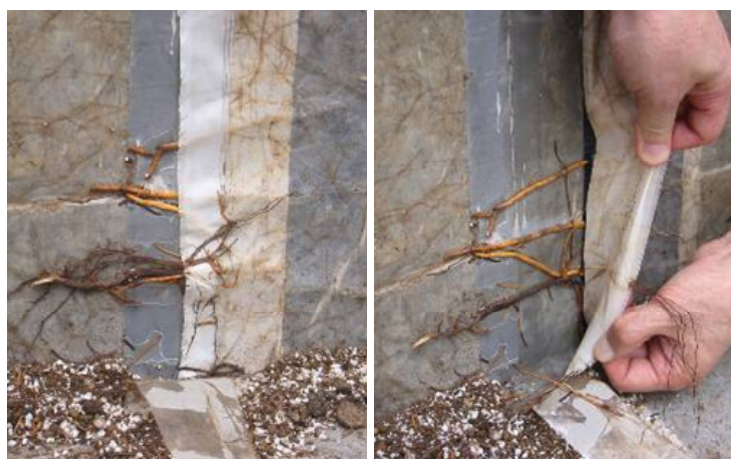
写真1.3 耐根シートジョイント部への根の侵入事例
