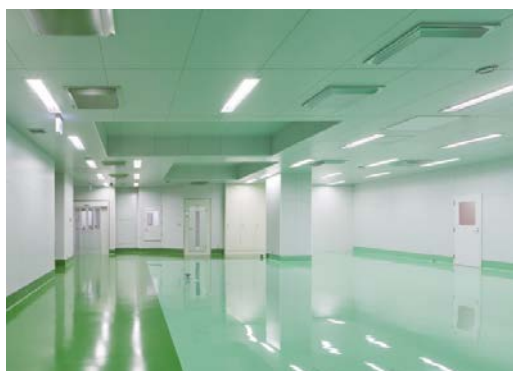
写真 2. 8. 2 クリーンルーム
