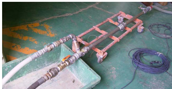
(a) 配管状況（左から右方向へ供給）
