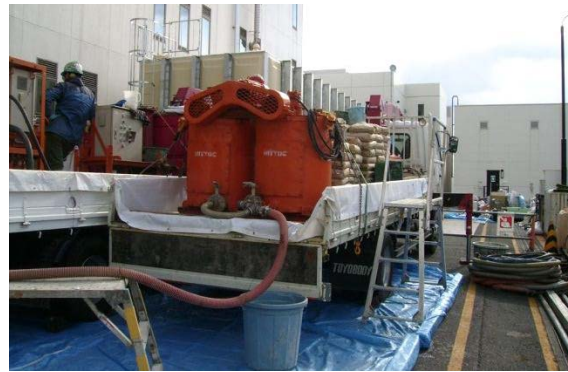
図-3.41 充填実験で用いたトラック搭載型の製造プラント
