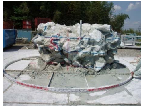
(b) 解体途中に確認した状況
