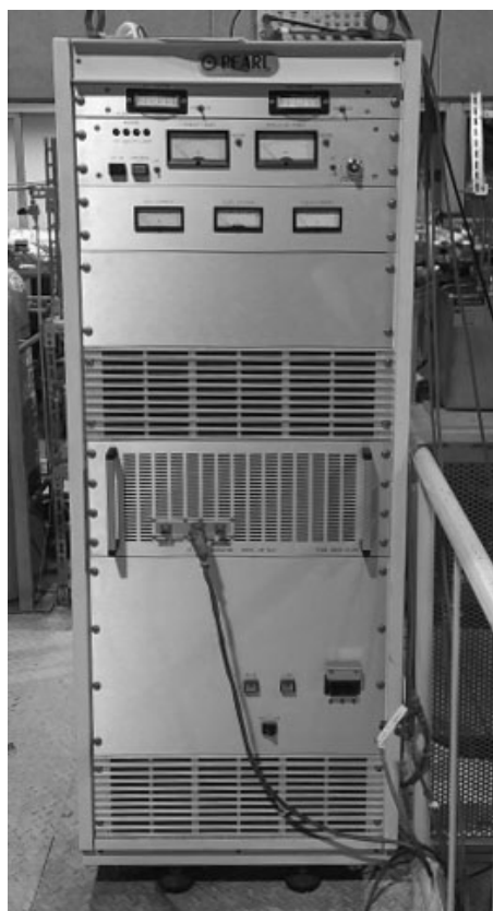
図 i-3 高周波電源装置
