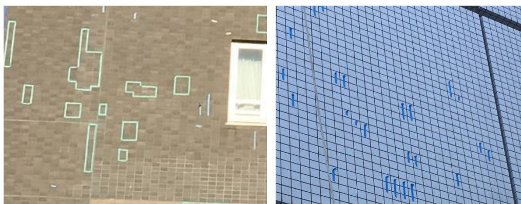
写真 1.4 剥離判定範囲の区画例
