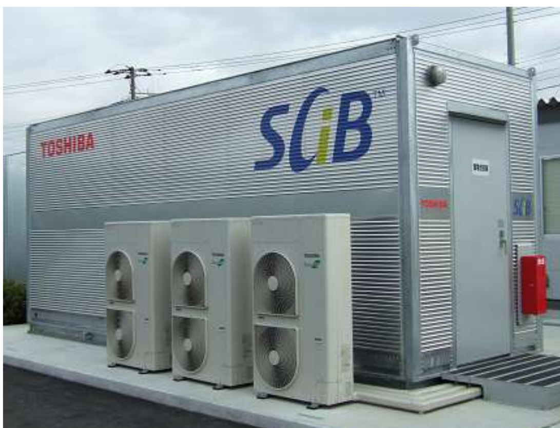
図 2-3 蓄電池システム実証機 外観
