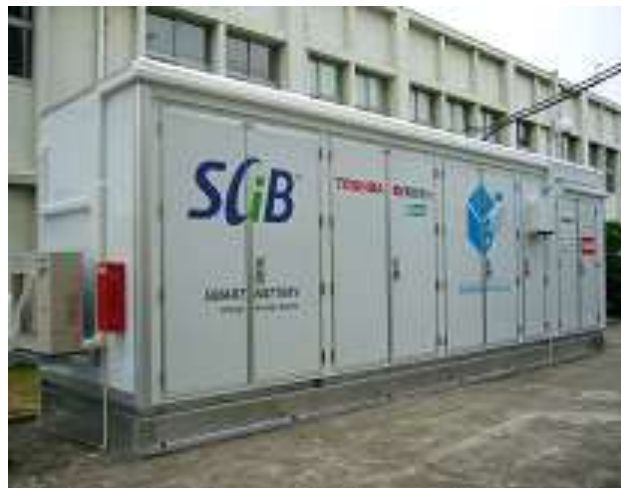
図 3-6 蓄電池システム (100kW-300kWh)
