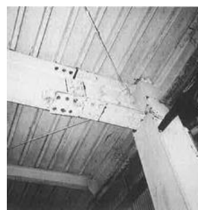
b-2) 梁継手ボルトの破断
