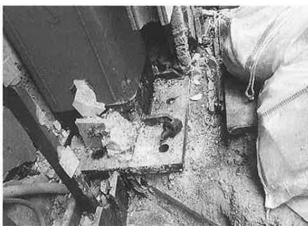
c-1) アンカーボルトの破断
