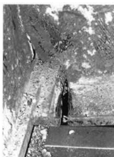
b-1) スラップ底からの 梁下フランジの破断
