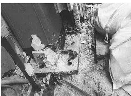
c-1)アンカーボルトの破断
