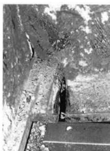
b-1)スカラップ底からの梁下フランジの破断
