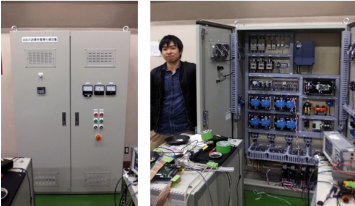
図 3.15: PHIX トロイダル磁場コイル用自励誘導発電機制御盤内外の写真
