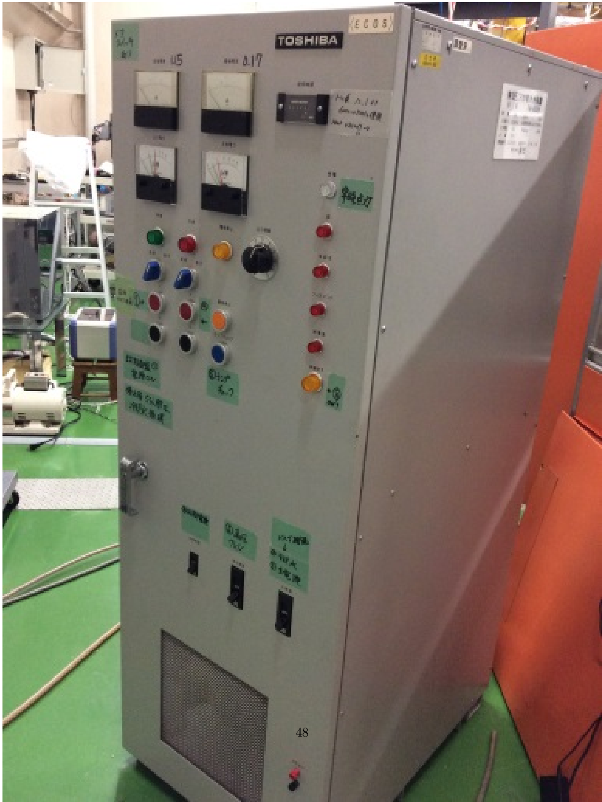
図 3.4: PHiX の予備電離用マグネトロン。2.45 GHz のマイクロ波を最大 5 kW で連続波 (CW) 出力することができる。トロイダル磁場による共鳴層がないときに真空容器へマイクロ波を入射すると内部が焼損する可能性があるため、トロイダル磁場コイル電源と同期して運転される。
