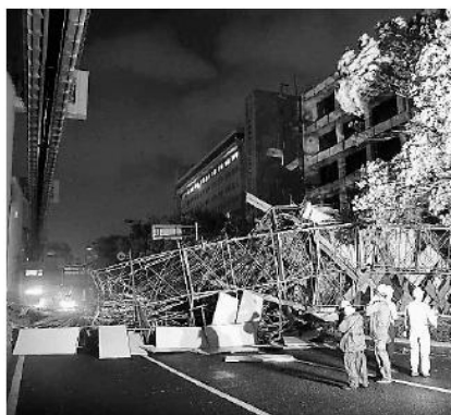
図 4-2 2012 年台風 4 号により千葉市で発生した解体工事の安全パネルの崩落 6)
