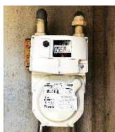
図1 ガスメーター
