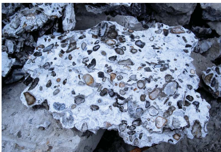
図-6.7 G橋の撤去作業中に見られたコンクリートの破壊面
