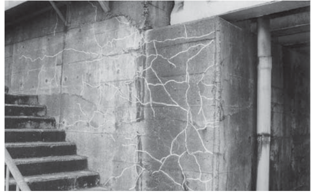
図-3.8 A2 橋台の陸側側面のひび割れ状況
