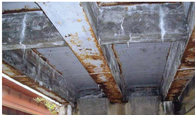
図-6.4 G橋の第1径間の漏水状況 8)
