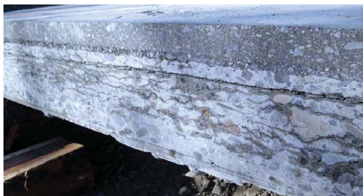
図-6.6 G橋RC橋部の撤去時に見られた床版の水平ひび割れ 3)
