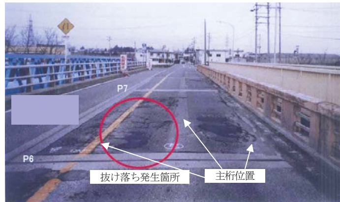
図-6.5 G橋床版抜け落ちの約2年前の舗装打換え前における橋面アスファルト舗装の劣化 7)
