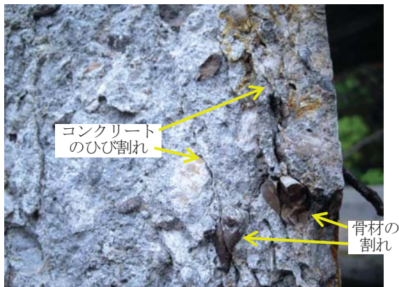
(b) 粗骨材の割れとコンクリートのひび割れ (その1)
