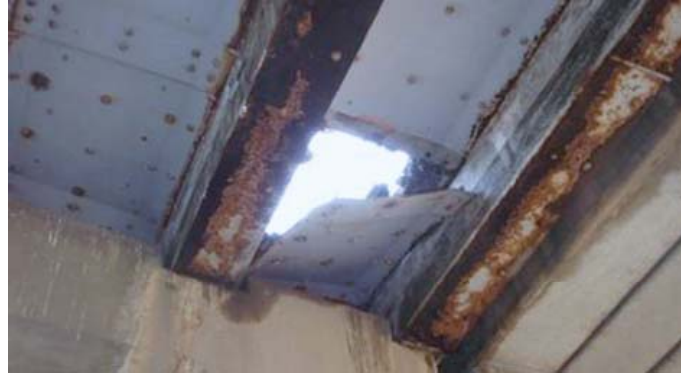
図-6.2 G橋の鋼板接着補強されたRC床版の抜け落ち 6),7)
