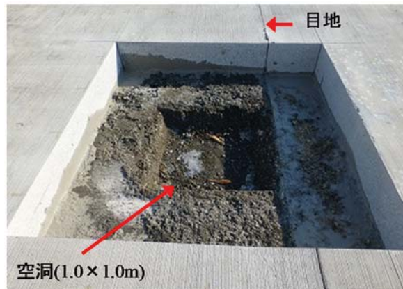
写真-4.1 空洞の生成状況 (目地部 1.0×1.0m の空洞)
