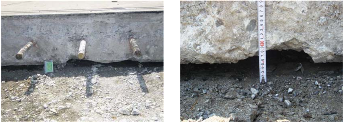
写真-3.1 K9のコンクリート版下の空洞
