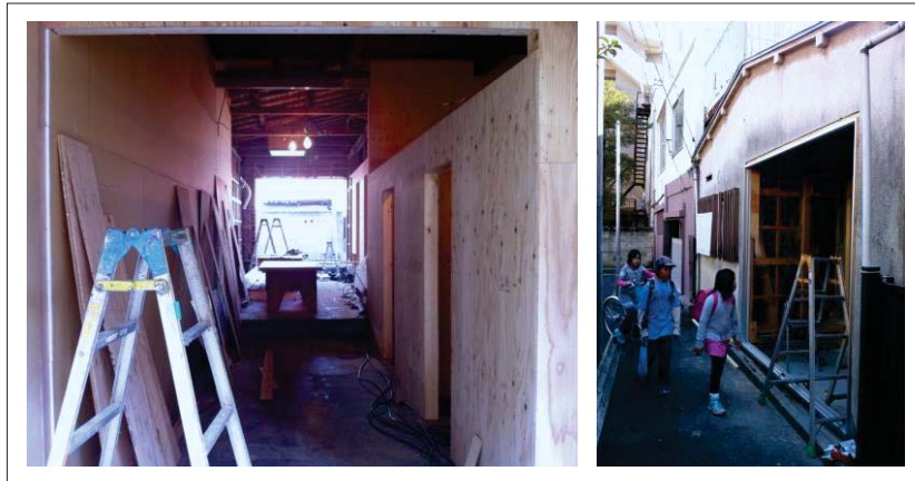
図 6-16 左：シネマスタジオ 2 改修時（共用部内観）、右：同改修時（路地側）
