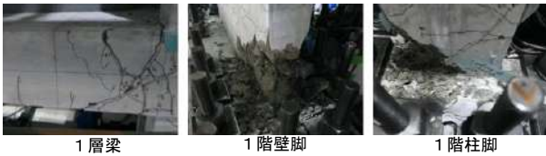
写真-1 補修前の様子
