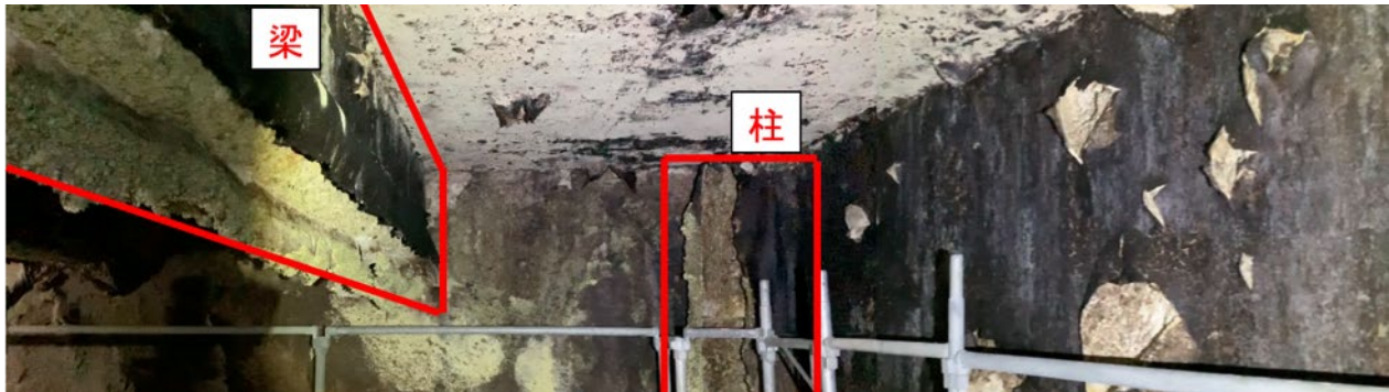
図-2 気相部の劣化状況
