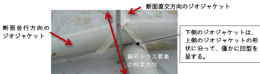
図 4.4.3.9 ジオジャケット交差部の状況
