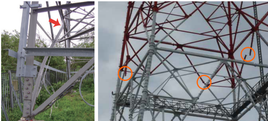
図 1.3.1 腹材が座屈・破断したトラス鉄塔の被害例（2007年新潟県中越沖地震 1.15),1.19) ）
