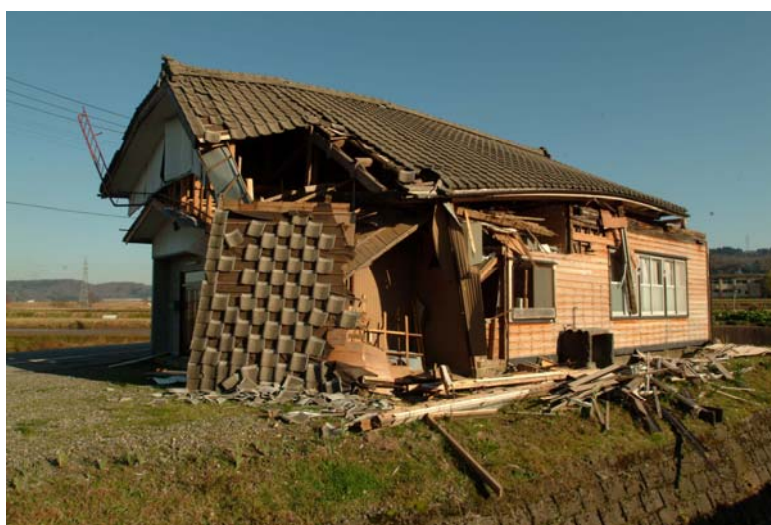
写真 1.1.2 小千谷市吉谷地区での公民館の被害（小千谷市役所より提供）
