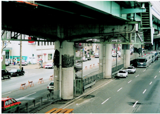
(a) 橋脚中間部の降伏からせん断破壊モード
