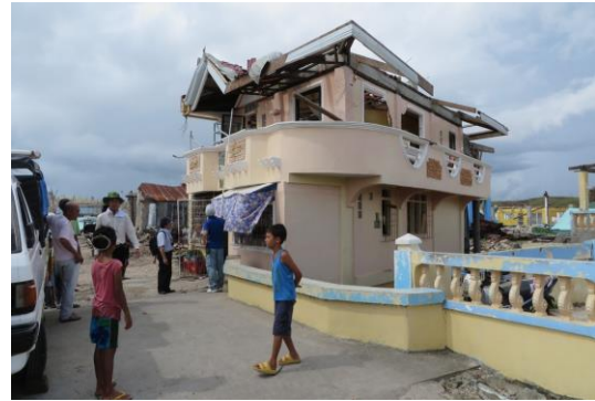
写真-6 Gigoso, Giporlosの被災した建物
