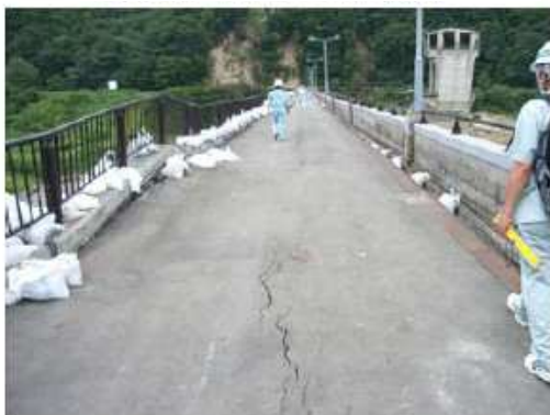
図-2.4.22 天端のクラックの状況 33)
