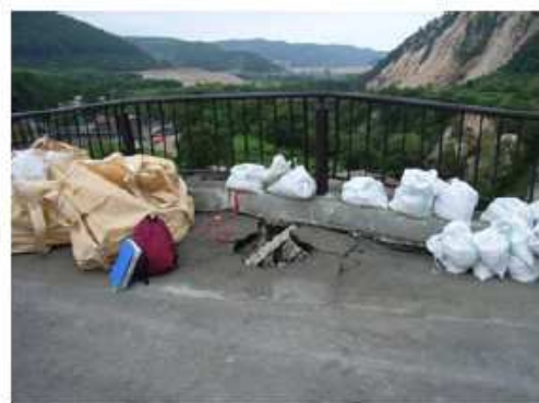
図-2.4.23 天端・転落防止柵の変形 33)
