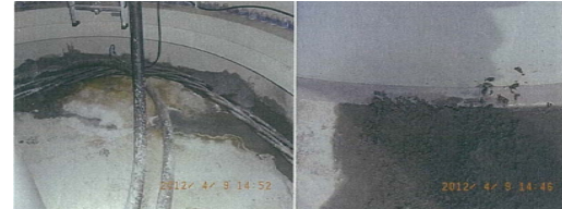
a) タワー内側の噴出状 b) 噴出したスラッジ
