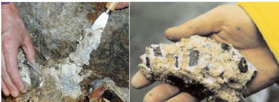
図 1.2-1 タウマサイト劣化の事例
