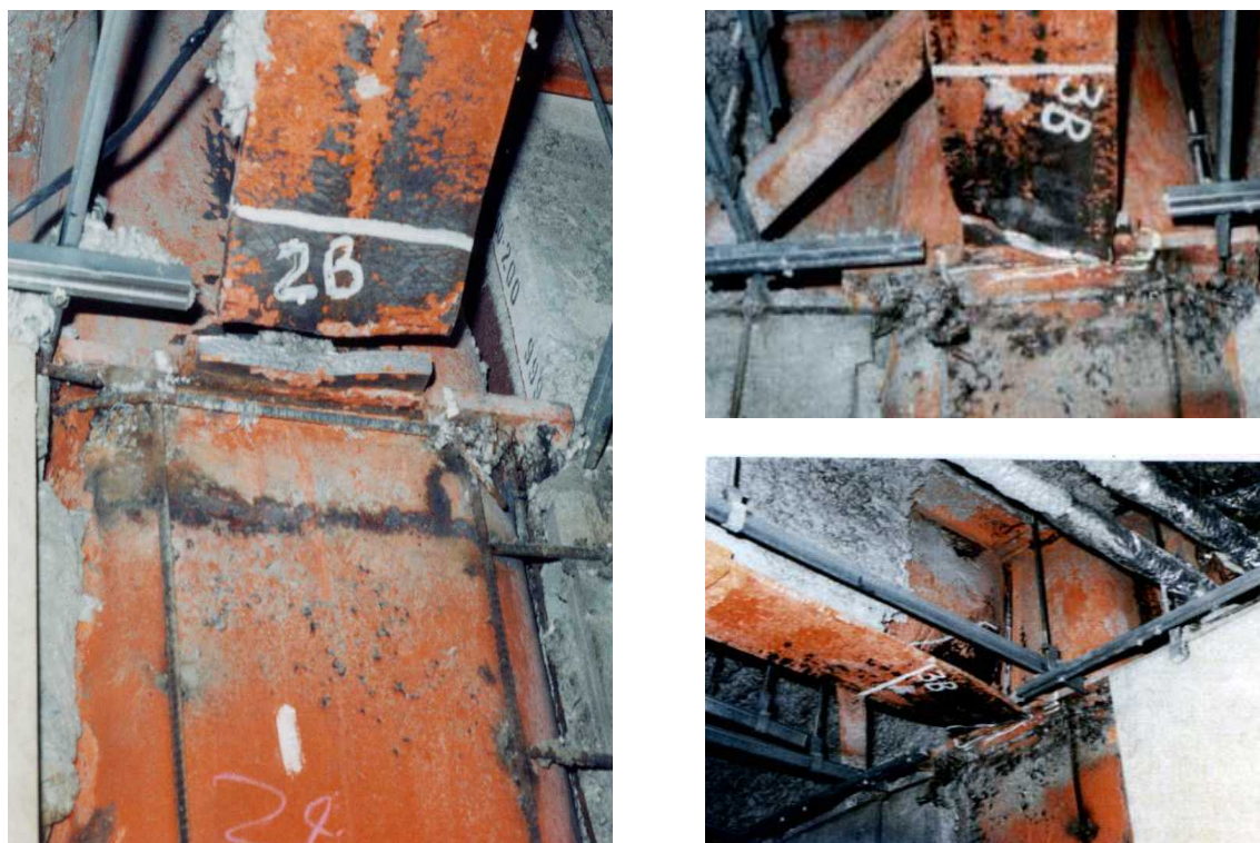
写真1.1 梁端下フランジの脆性破断
