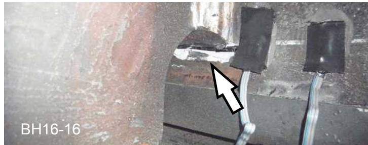
スカラップ底から延性亀裂が進展
