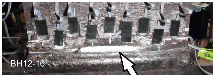
梁フランジ中央の溶接止端部から延性亀裂が進展
