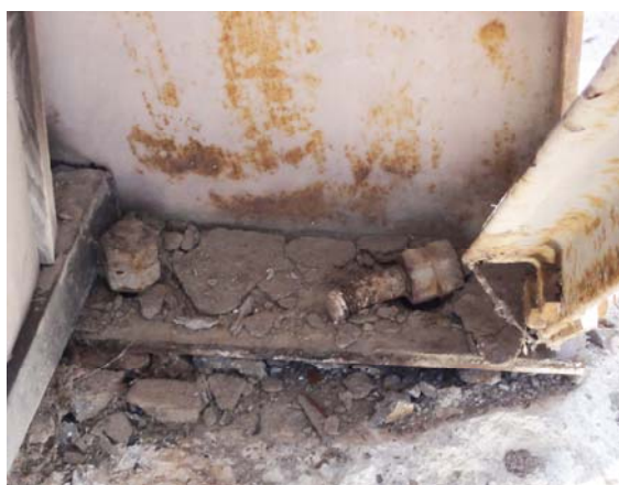
(a) アンカーボルトの破断
