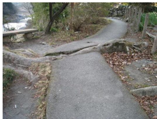
写真2.2 アスファルト舗装の分断
