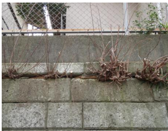
写真1.2 根による石組壁の損傷事例
