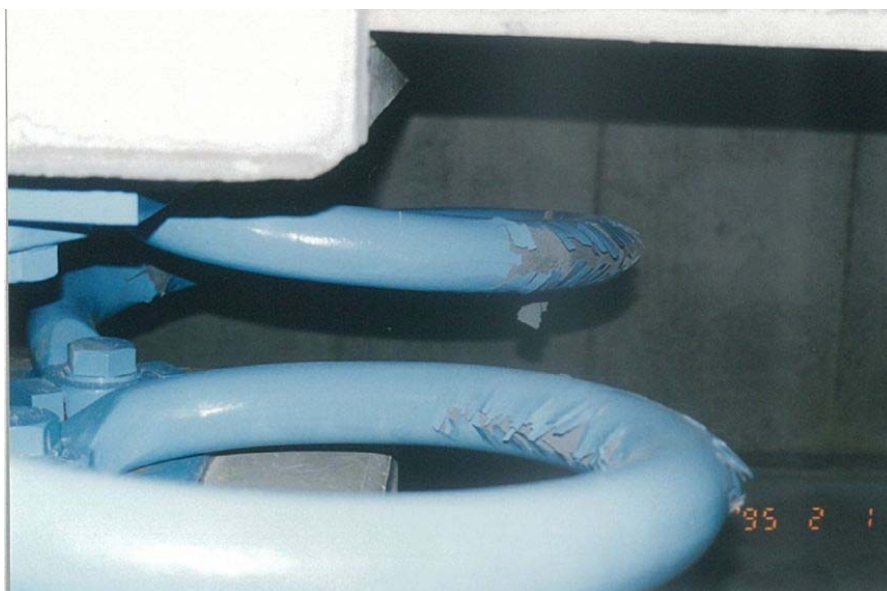
図7.14 鋼棒ダンパーの塗装の剥がれ
