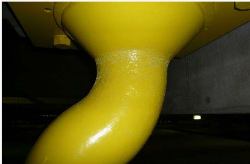
図 7.30 地震後のダンパーの状況
