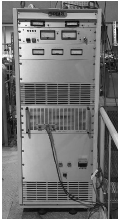
図 i-3 高周波電源装置
