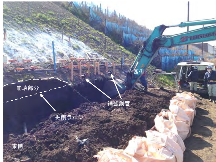
写真 5.4.5 無補強区間のオーバーハング掘削面が崩壊【46分】
