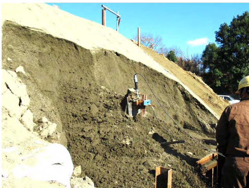
付 C 写真 1.10 受圧板の支持地盤を掘削し移動土塊が崩壊（側面）
