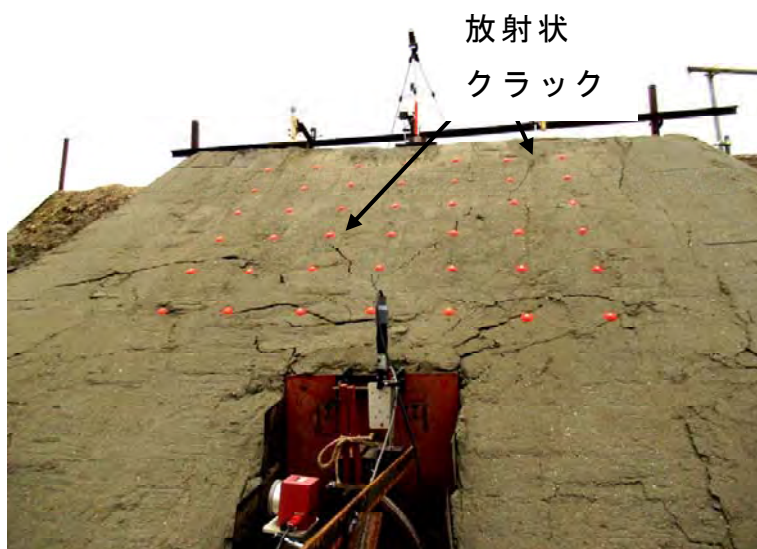
写真 3.3.4 TK-600 除荷実験後
