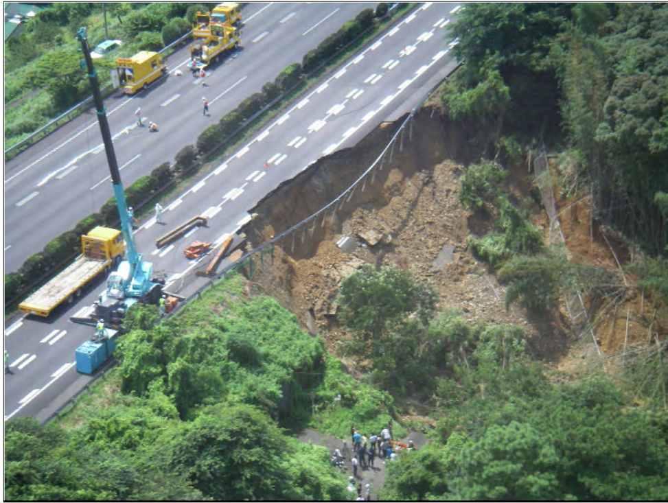
写真 1.1.4 東名高速道路の盛土斜面崩壊箇所 1-6)
