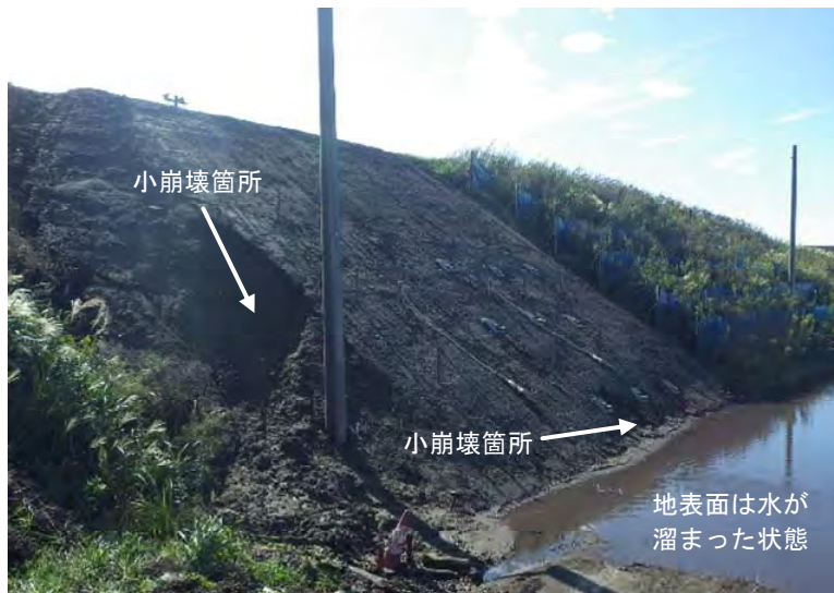
写真 5.6.5 完成 1 ヶ月後の台風による試験盛土の小規模な崩壊 (妻側の覆土部分と最下段の鋼管どうしの中の法先)
