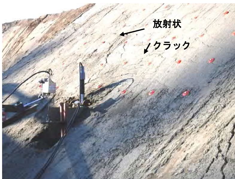
写真 3.3.3 TK-300 除荷実験後
