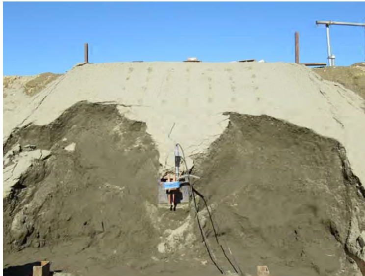
付 C 写真 1.6 受圧板が支持する移動土塊の範囲を確認（正面）
