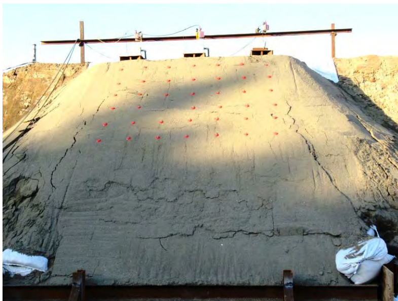
写真 3.3.2 TK-N (無補強) 除荷実験後
