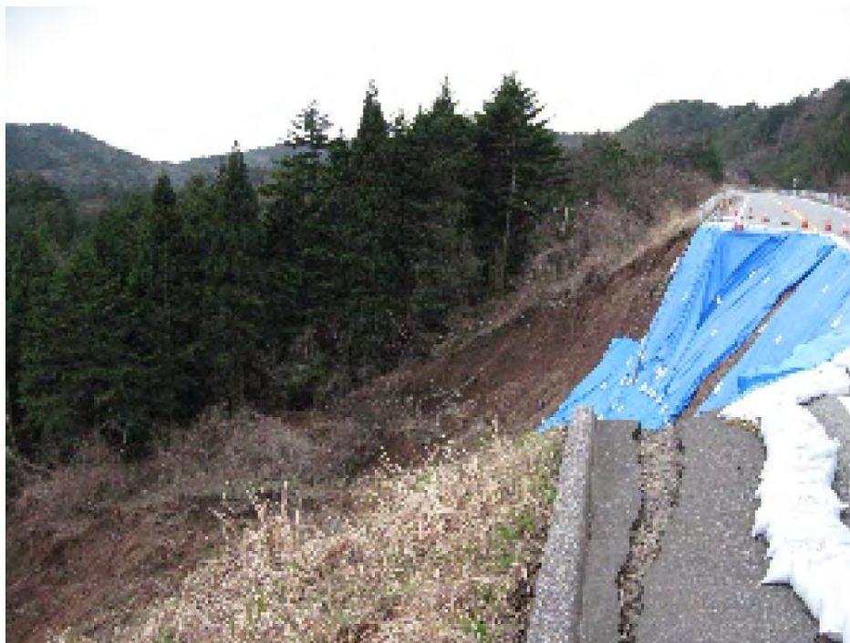
写真 1.1.3 能登有料道路（当時）の盛土斜面崩壊の例 1-5)
