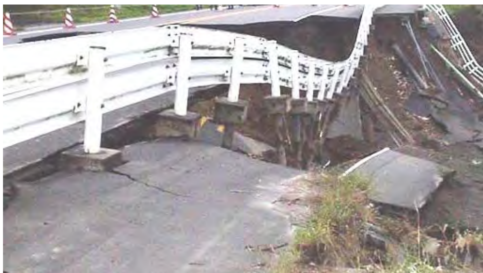
写真 1.1.2 2004 新潟県中越地震による道路盛土の斜面崩壊の例 1-3)
