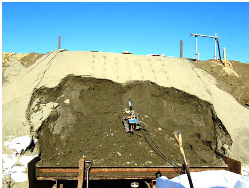
付 C 写真 1.9 受圧板の支持地盤を掘削し移動土塊が崩壊（正面）
