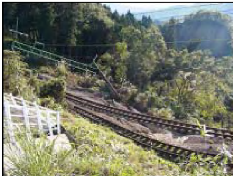
写真 1.1.1 2004 新潟県中越地震による鉄道盛土の斜面崩壊の例 1-3)
