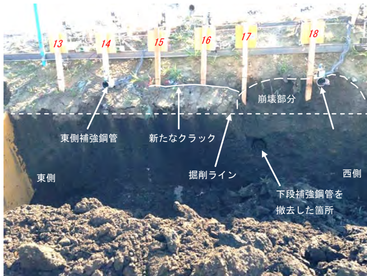
写真 5.4.7 補強区間の西側の掘削面が崩壊【51分】
