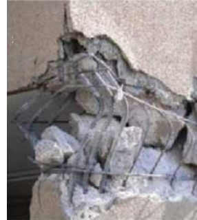
(d) Concrete crushing and reinforcement buckling
