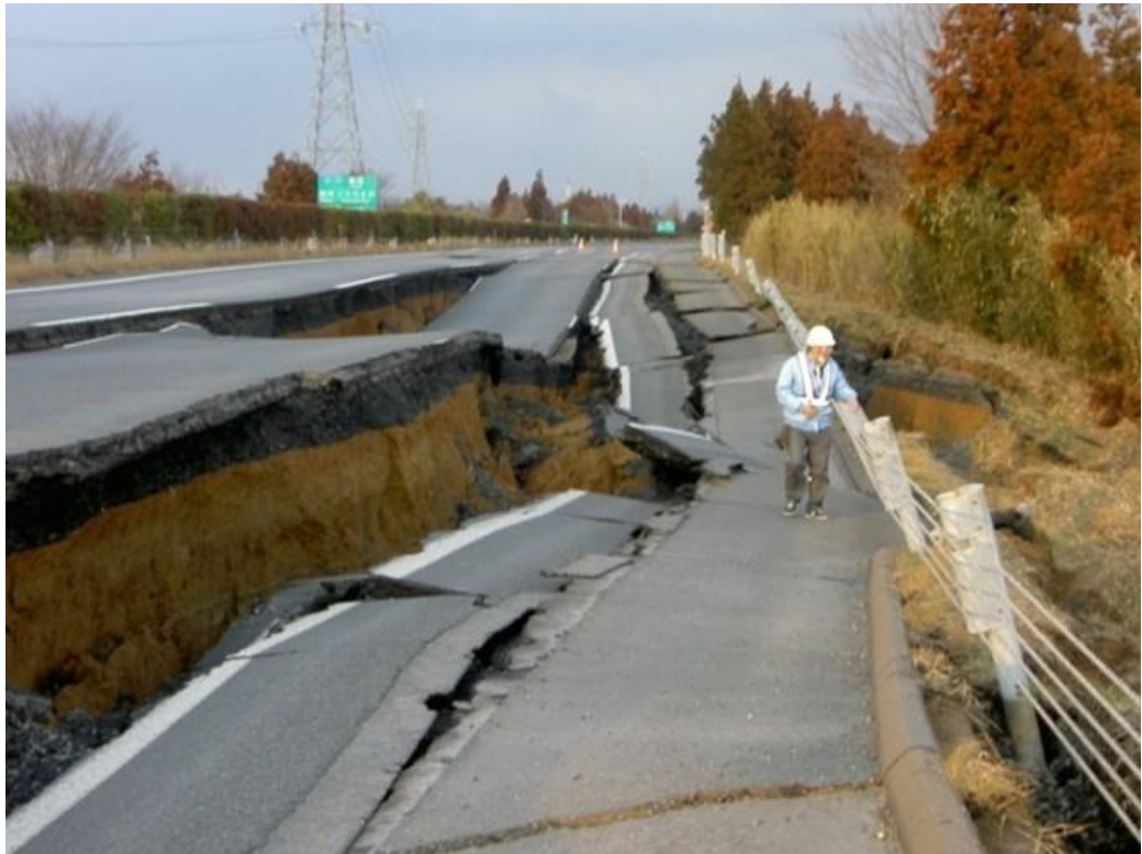
图 1-3 常磐自動車道 那珂地区，盛土崩壊状況
