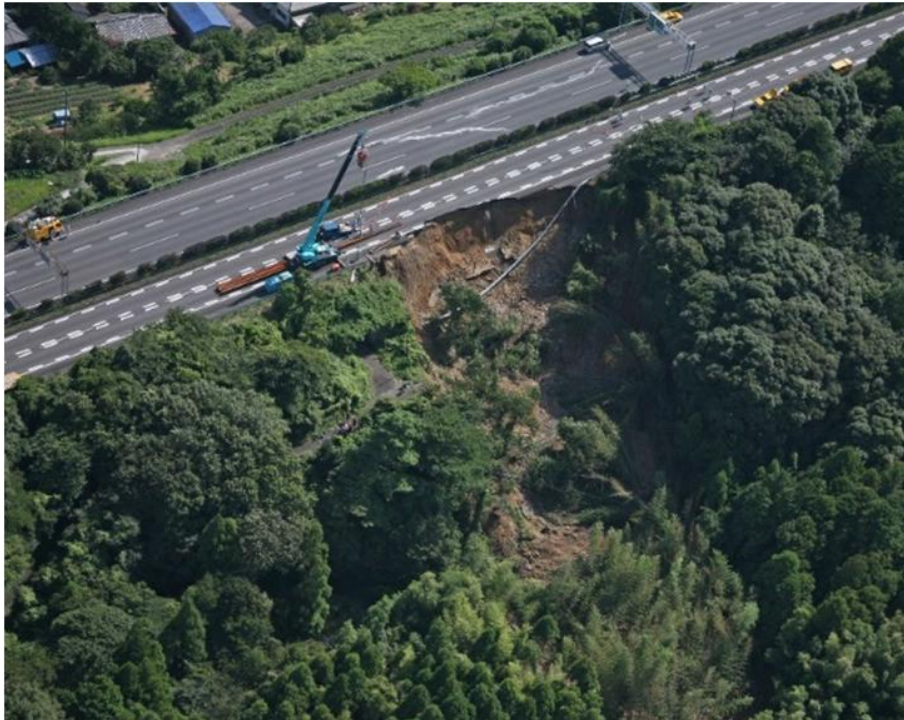
図 1-1 東名高速道路 牧之原地区の盛土崩壊状況
