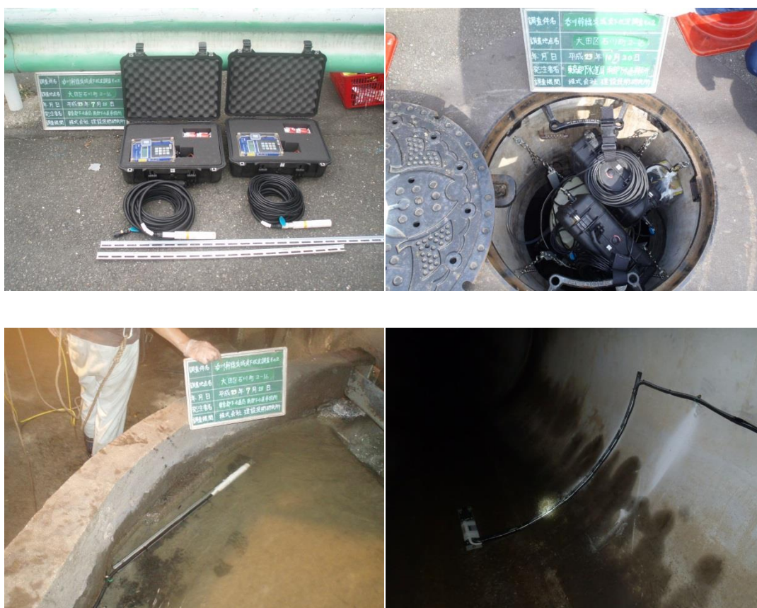
図 3-4 水位計の外観と設置イメージ
