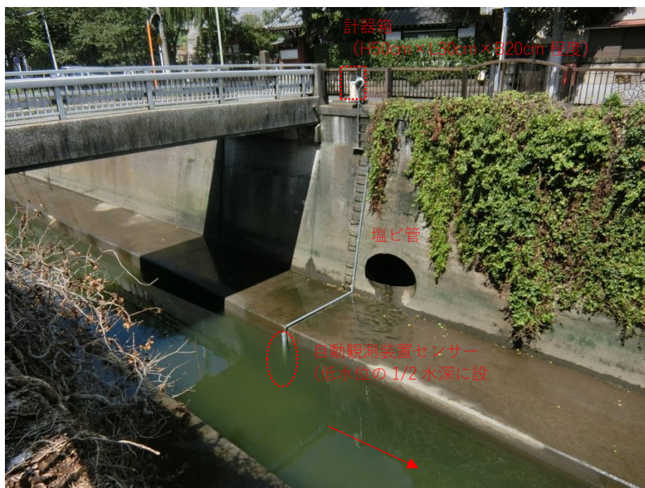
写真 3-1 自記式濁度計 設置状況 (養源寺橋)
