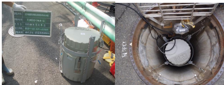
図 3-6 自動採水器の外観と設置状況
