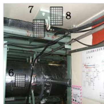
MS トンネル室の入口側から見た No. 6 No. 7 及び No. 8 の設置 場所
