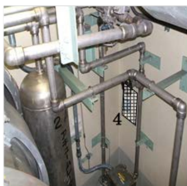
壁側に設置された No. 4 の 設置場所
