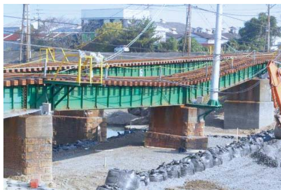
図1-1 男里川橋りょうの災害発生後の状況（埋め戻し後）
