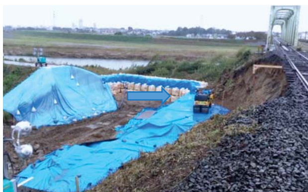
図2-5 堤防越流による橋台背面の線路盛土の流出事例 31)
