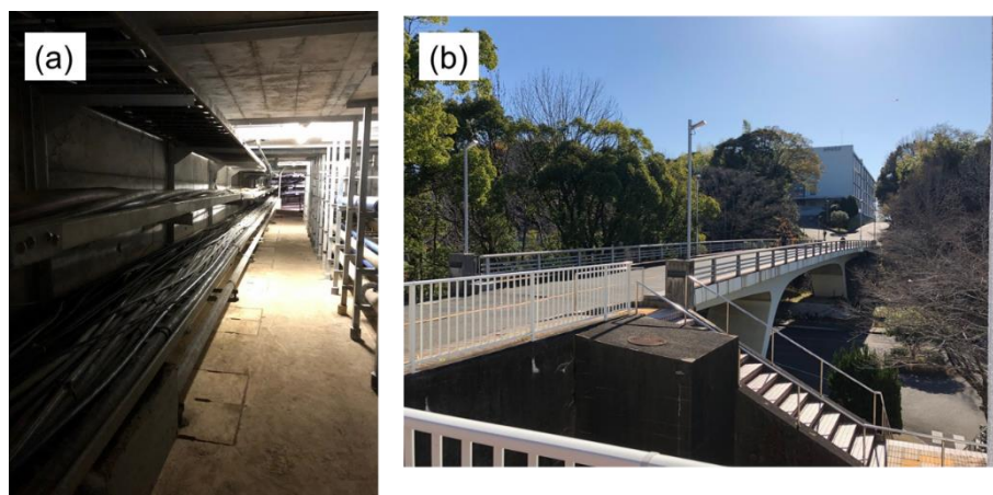
図 A1-2 (a) 通信ケーブルが収められた地下の共同溝 (b) 陸橋
